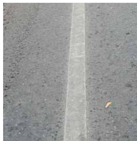
Рисунок 2. Горизонтальная дорожная разметка 1.1, загрязненная нефтепродуктами
